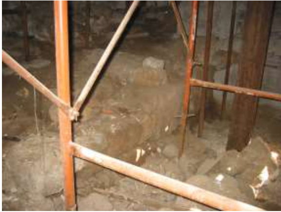
Εικ. 15 Χαμηλός τοίχος με μεγάλους δόμους στο εσωτερικό του δυτικού τμήματος του πύργου, ο οποίος φαίνεται να αντιστοιχεί στο μεταπύργιο δυτικά.
